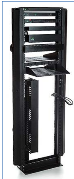
Ilustración 2. Rack de comunicaciones
